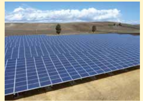
L'impianto fotovoltaico nello stabilimento di Enna.
