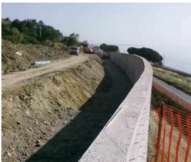
Figura 1 Esempio di muro di sostegno dissestato.
