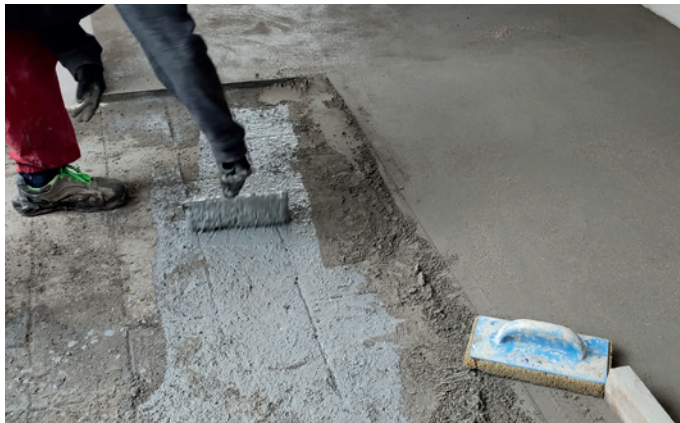
Posa della boiaccia di aggrappo con Lattice CentroStorico per la posa in aderenza del massetto delle pendenze QuotaZero.
