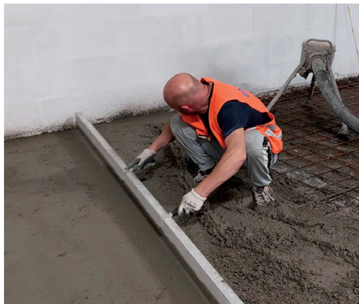
Posa fresco su fresco del calcestruzzo leggero strutturale LecaCLS 1400 su superficie trattata con Connettore CentroStorico Chimico.
