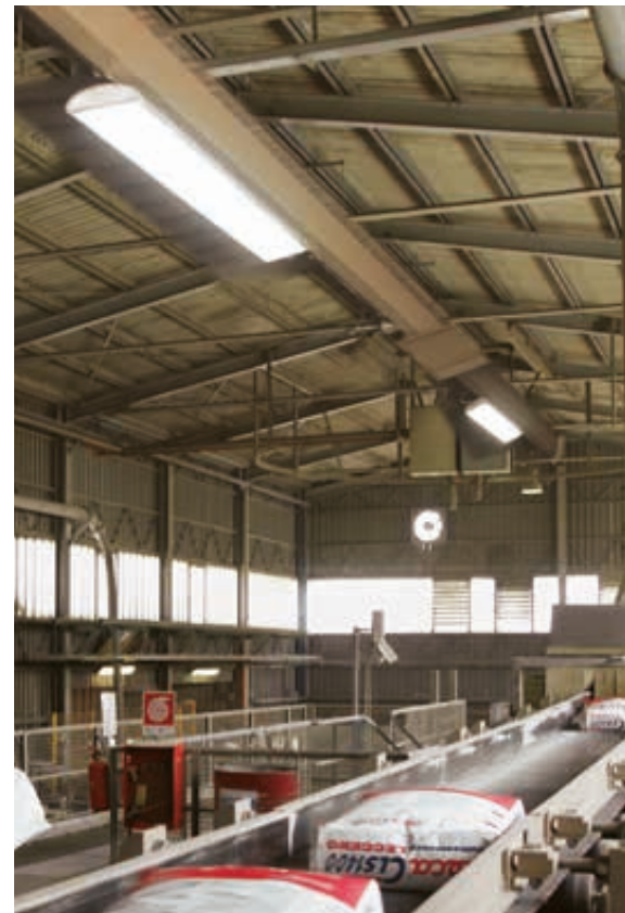
Nuovi impianti di illuminazione a tecnologia LED.
