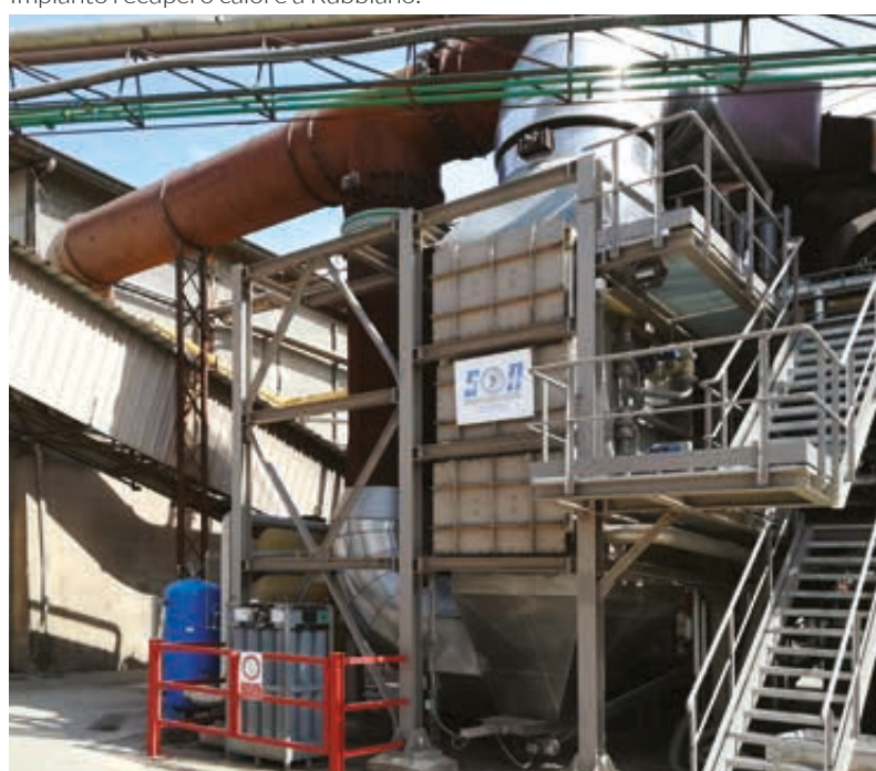
Impianto recupero calore a Rubbiano.
