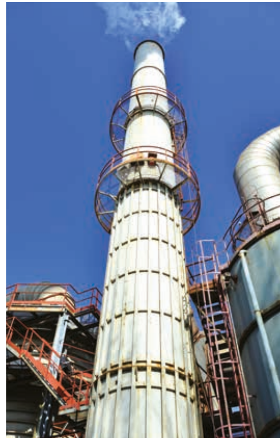
Impianti di abbattimento dei fumi.
