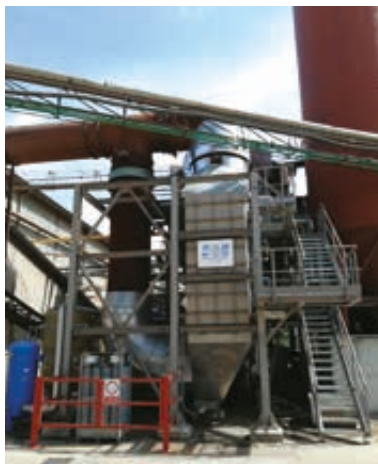
Impianto recupero calore a Rubbiano.
